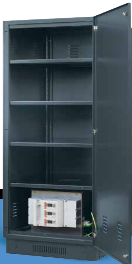
3 106 59 hasta 62 baterías 41 Ah
